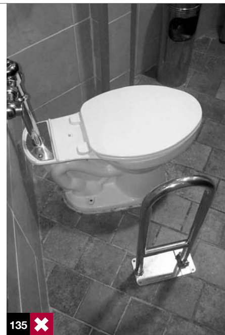
Foto 135: barra de muro instalada al piso. No cumple su función.
