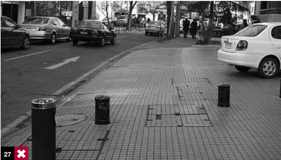
Foto 27: la circulación peatonal se ve afectada por una pendiente transversal excesiva. Santiago, Chile.
