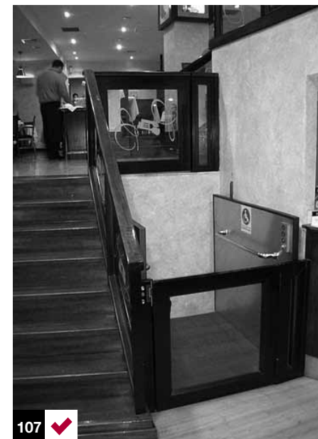
Foto 107: plataforma vertical instalada como opción a escalera. Santiago, Chile.
