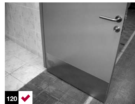
Foto 120: puerta batiente en baño de colegio con apertura hacia afuera. Santiago, Chile.
